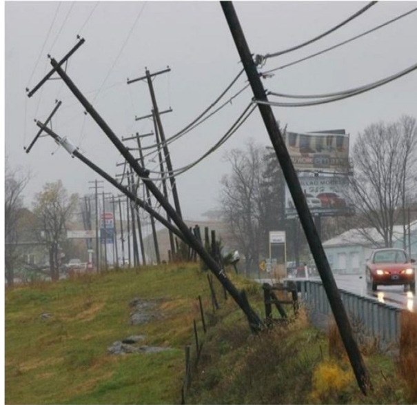
Σχήμα 12: Αστοχία στύλων διανομής ηλεκτρικής ενέργειας (Vivek et al. 2017)
