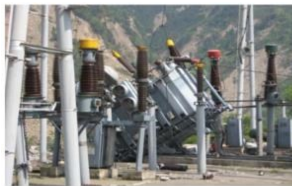
(β) Βλάβες σε εξαρτήματα των υποσταθμών
