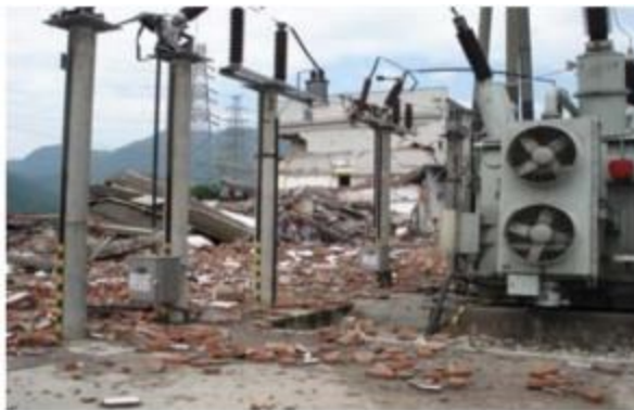
(α) Κατάρρευση κτιρίου ελέγχου
